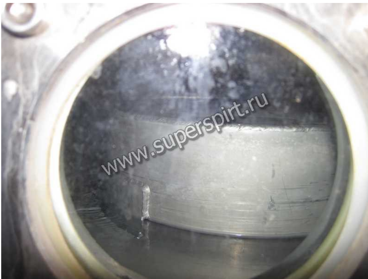
Рис.1 Вид через смотровое окно бражной колонны, которую заливало флегмой.
