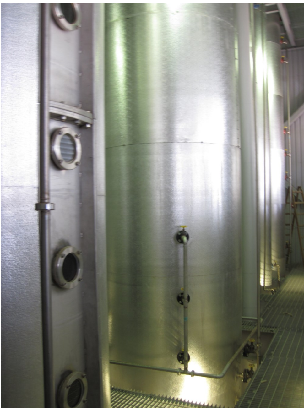
Рис.2 Смотровые окна на колонне (не очень удобные).
